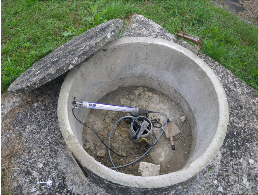
Figure 29 - Intérieur du piézomètre BRGM et matériels de suivi (source : BRGM)
