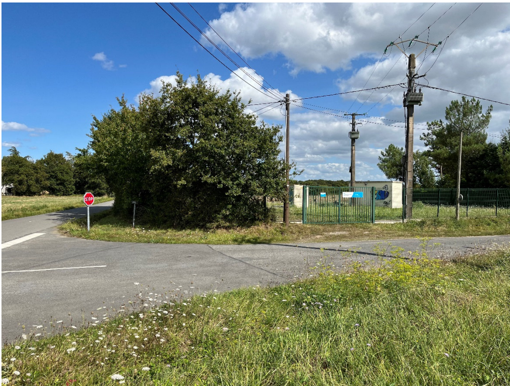
Figure 22 - Captage d'eau potable de la Pavais à Chartres-de-Bretagne (source : BRGM)
